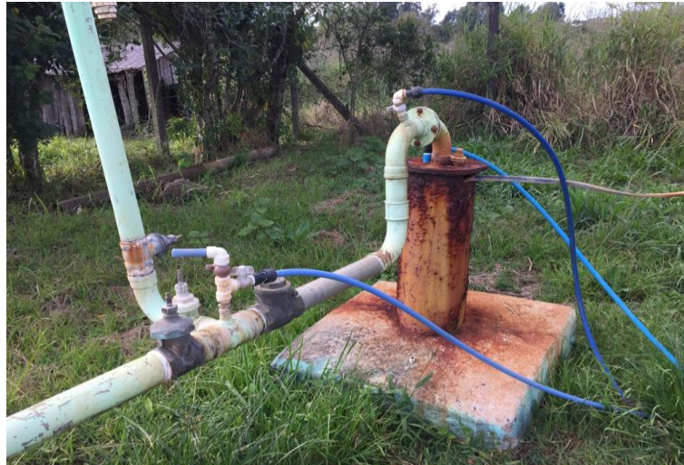
Figura 3 - Pontos de oxidação de um dos poços de abastecimento de Faxinalzinho, RS.
